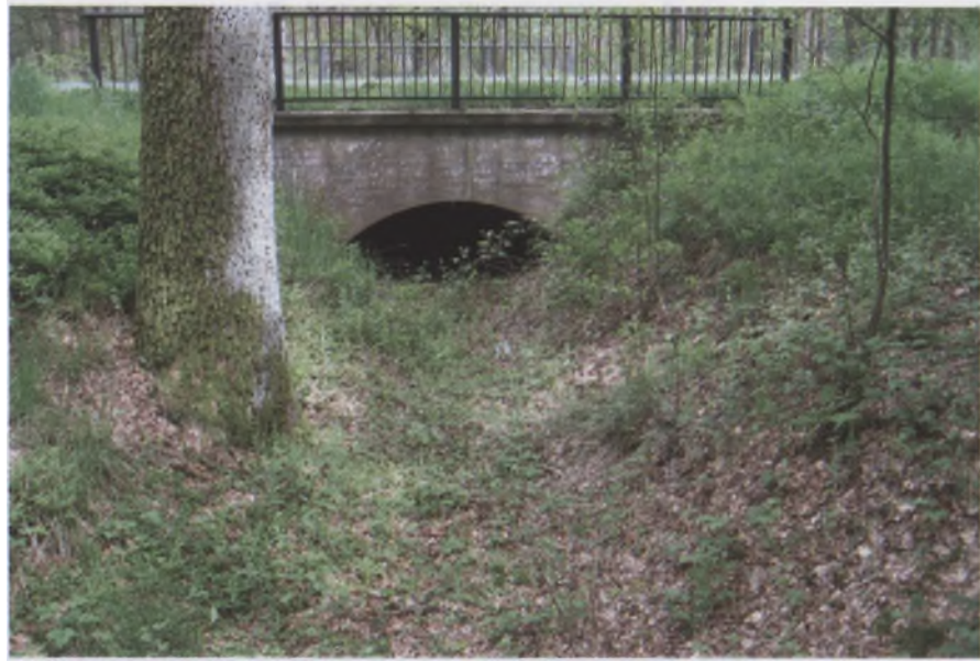
Abb. 2: Wümmme - Bachschwinde, Straßendurchlass Bundesstraße 3 südlich Wintermoor (Abschnitt I), 2.6.2013.
